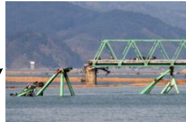
落橋した新北上大橋。手前は、上流500m地点まで押し流された鉄骨
